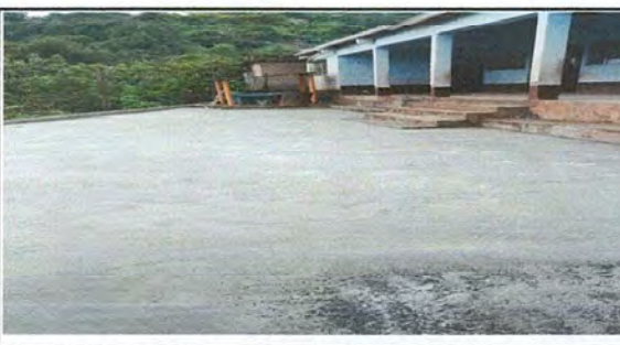
Foto 6: Sustrucción de piso de torta de concreto
