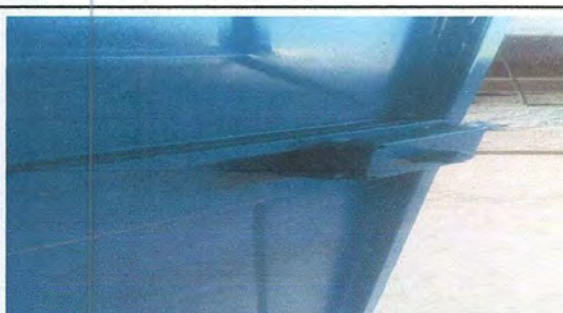
Foto 3: Sustrucción de chapa
