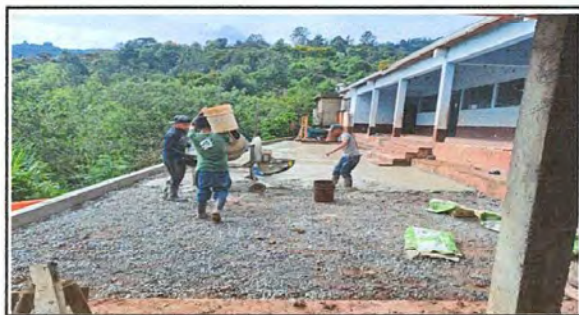
Foto 6: Sustrucción de piso de torta de concreto
