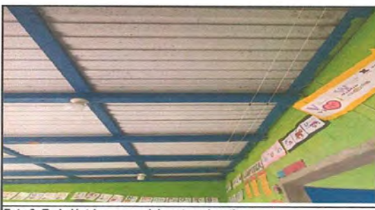
Foto 6: Red eléctrica nueva del centro educativo
