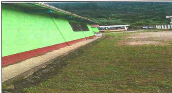
Foto 3: Cuneta de los modulos actuales
