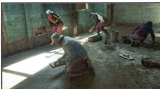
Foto 4: Sustrucción de piso de torta de concreto
