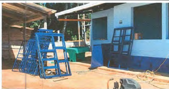
Foto 5: VENTANAS A SUSTITUIR
