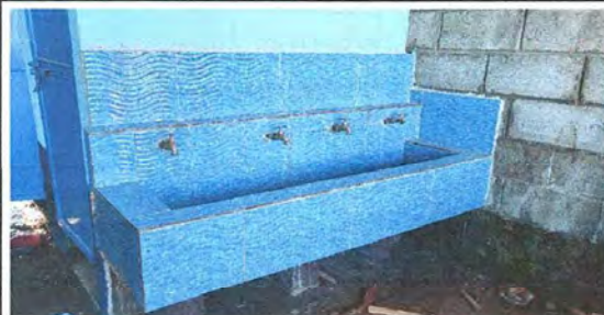
Foto 6: AZULEJO EN AREA DE LAVAMANOS
