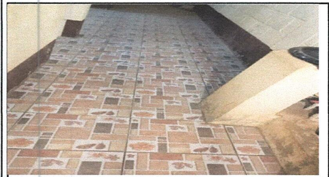
Foto 3: PEGADO DE PISO EN SANITARIOS
