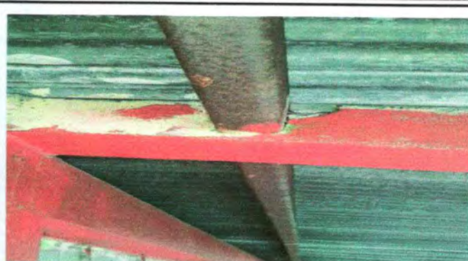
FOTO 2: FISURA EN VIGAS
