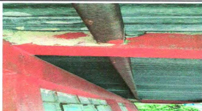
FOTO 3: FISURA EN VIGAS
