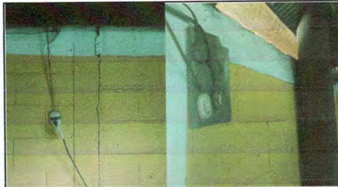
Foto 15 y 16: Interruptores y tomacorrientes de la cocina.
