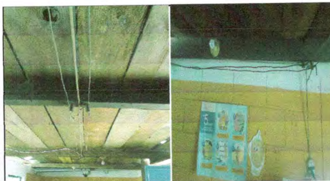
Foto 13 y 14: Cableado eléctrico de la cocina y Focos.
