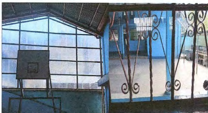
Foto 3: LÁMINAS Y VIDRIOS TRANSPARENTES EN VENTANAS QUEBRADAS
