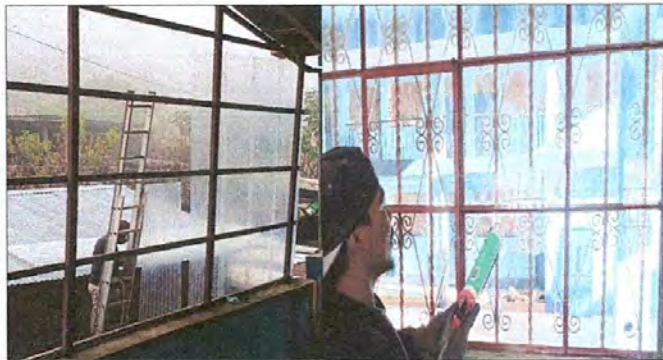
Foto 3: LÁMINAS Y VIDRIOS TRANSPARENTES EN VENTANAS QUEBRADAS
