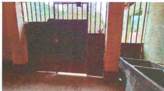
Foto 2: Sustrucción de un portón
