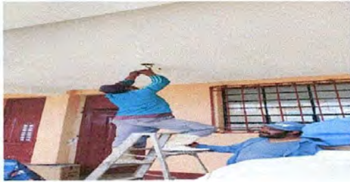
Foto1: sustitución de bombillas ahorradoras
