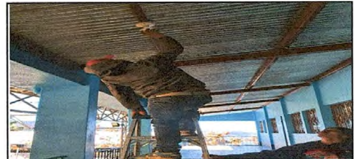
Foto 12: sustitución de focos por focos ahorradores
