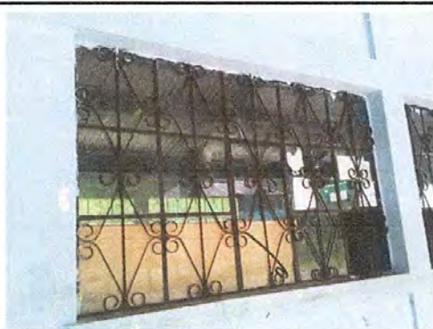
Foto 10: Sustrucción de balcones de metal de 2.12 mx1.36m
