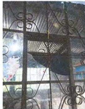
Foto 8: Sustrucción de vidrios de 35cmx39cm.
