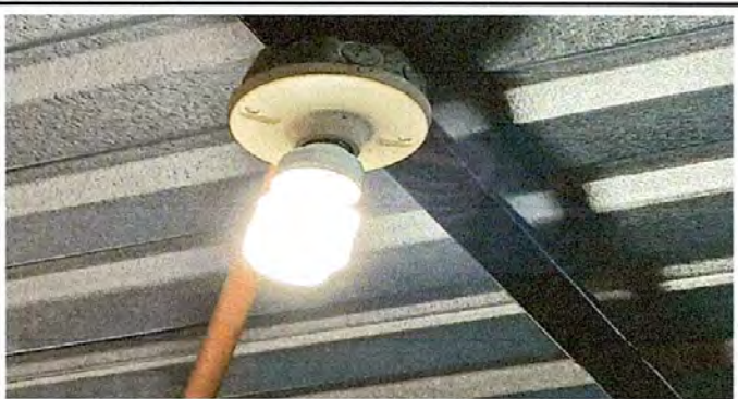
Foto 17: Sustrucción de focos
