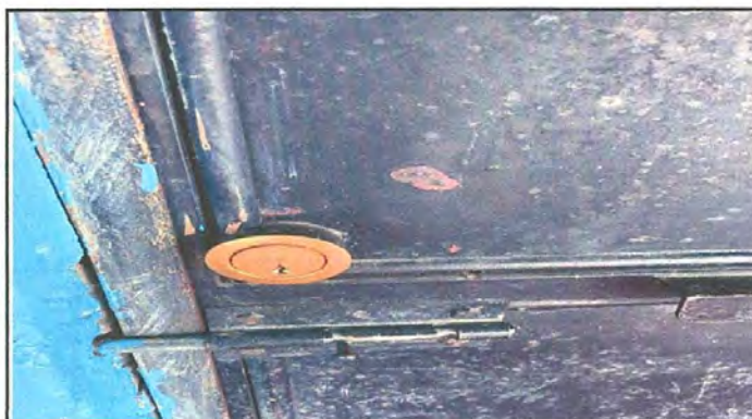
Foto 4: cambio de chapas yale ya se encuentra en mal estado por lo que se prioriza su sustitución.
