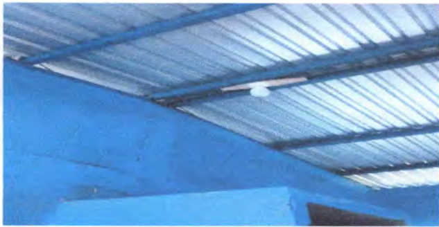
Foto 3: focos instalados en las aulas
