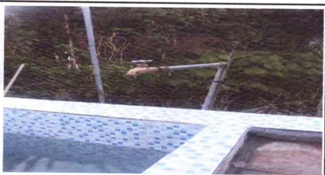
Foto 3: Llaves instaladas en el chorro
