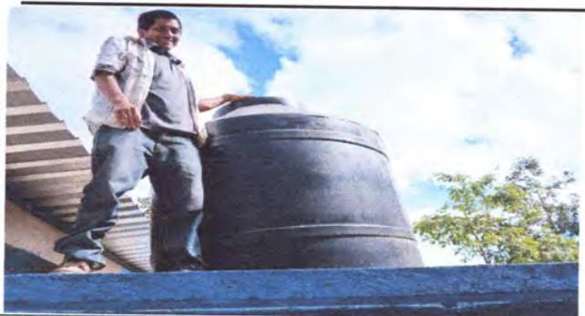
Foto5 cambio de cisterna
