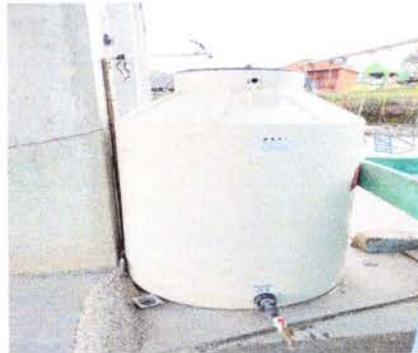
Foto 14: Sustitucion de deposito de agua de 1100 lt. el que se esta utilizando esta agrietado y se sale el agua.
