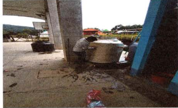
Foto 14: Sustitucion de deposito de agua de 1100 lt.el que se esta utilizando esta agrietado y se sale el agua.
