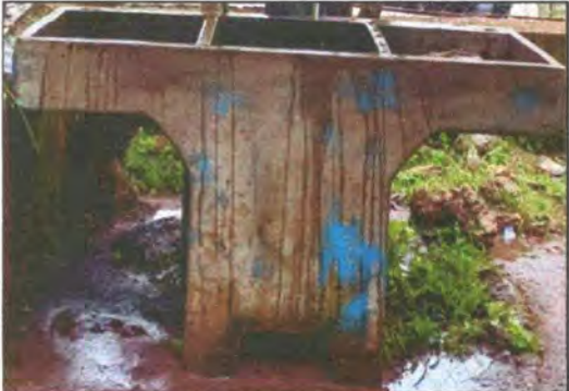
FOTO 9: La pila está deteriorada .
