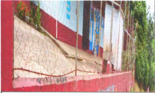
FOTO 6:Malla de muro perimetral en malas condicione
