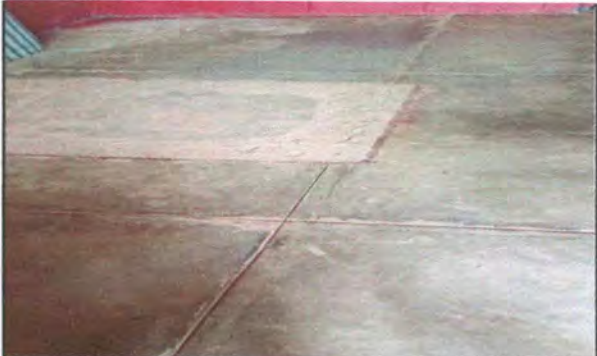
FOTO 2:El piso de cemento se está deteriorando y es necesario cambiarlo.
