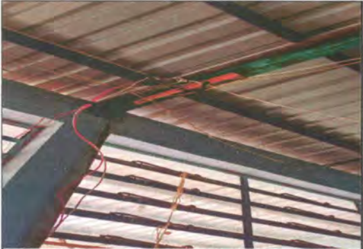
Foto 8: El cableado eléctrico se encuentra expuesto
