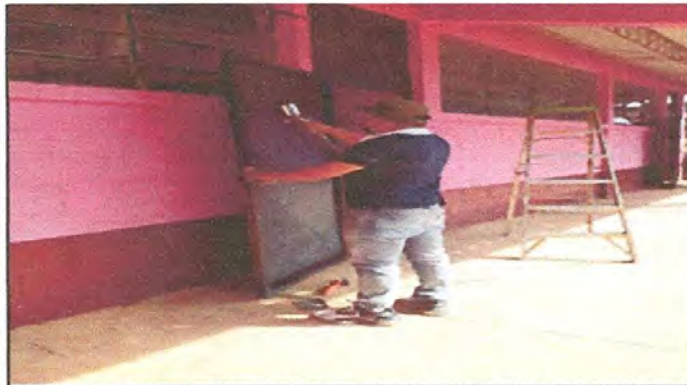
Foto 4: Puerta de las aulas. Mantenimiento de las puertas de metal pintado y cambio de las chapas.
