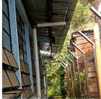
Foto 8: Sustrucción de canal de metal
