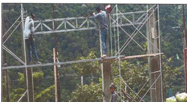
Foto 4: Módulo 2, estructura débil, falsa, lámina con filtraciones; reparación completa
