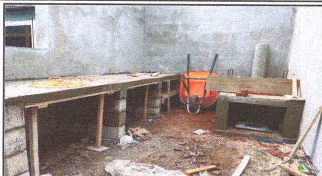
Foto 1: Vista de Fogón, Plancha, Piso y mesa de servicio todo en deterioro ya en reparación
