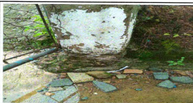
Foto 24: Sustrucción de poste de concreto perimetral
