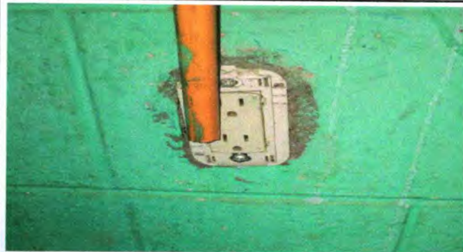
Foto 20: Sustrucción de tomacorriente
