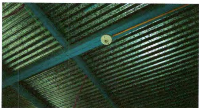
Foto 19: Sustrucción de plafoneras
