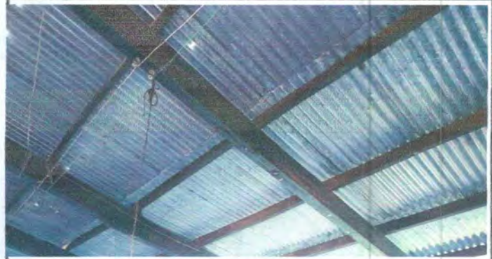
Foto 2: Las laminas estan agujeradas y las bigas corcomidas por las polias.
