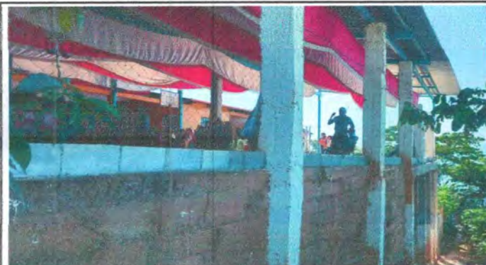
Foto 3: se necesita levntar un muro perimetral.
