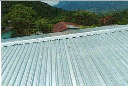
Foto 1: lámina en malas condiciones
