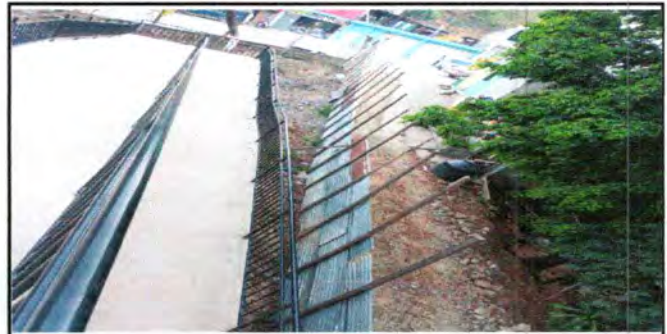
Muro totalmente caído
