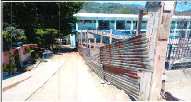
Muro totalmente caído
