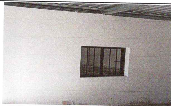
Foto 10: Repello en paredes
