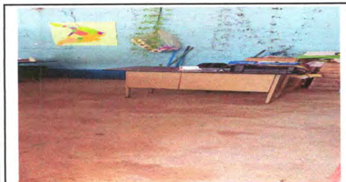
Foto 5: área donde se sustituirá piso cerámico
