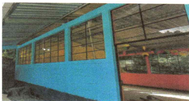
Foto 5: Pintura en paredes de aula
