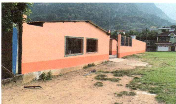
Foto 5: Pintura en paredes de aula en mal estado
