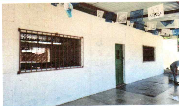
Foto 5: Pintura en paredes de aula en mal estado
