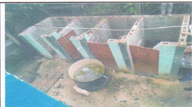
Foto 3: Servicios sanitario y sus accesorios
