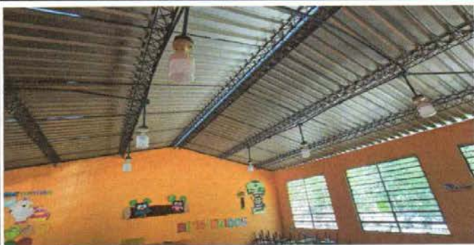
Foto 10: Mejoramiento de lamparas led
