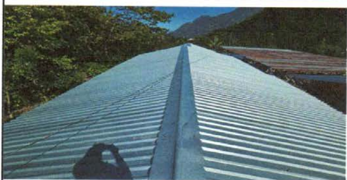
Foto1: Sustrucción de lámina en mal estado.
