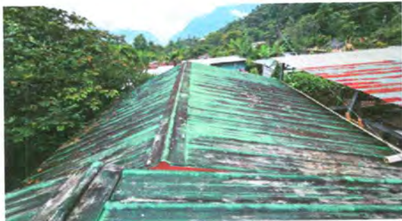
Foto1: Sustrucción de lámina en mal estado.
