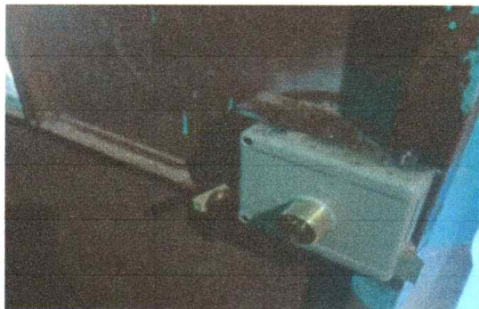
Foto1: Sustrucción de chapa
