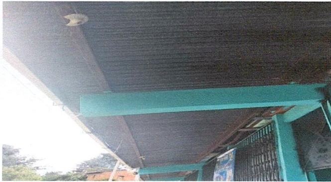
Capotes y láminas en mal estado del techo del corredor de la escuela
