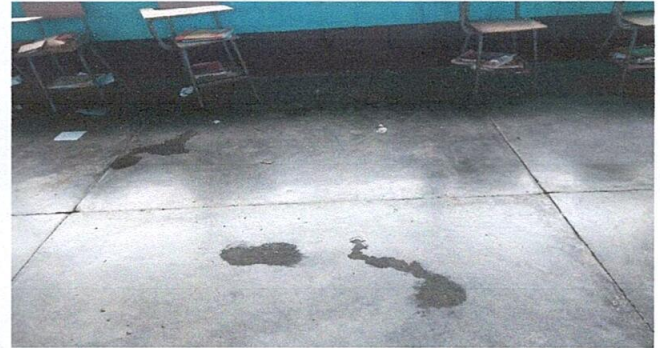
En todas las aulas caen goteras por el mal estado del techo, el cual desde la fundación de la escuela no se ha cambiado.
