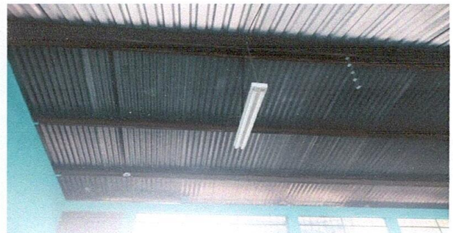
Techo en mal estado y dañado por las fuertes lluvias ocurridas por la tormenta pilar y tomacorrientes, lamparas en mal estado, costaneras y puertas occidadas por el tiempo de su existencia.
