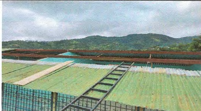
Foto1: Desprendimiento de capote
