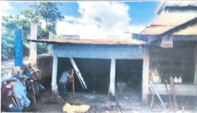
Foto 1: Destrucción de una pared de la cocina que servía como muro perimetral.
