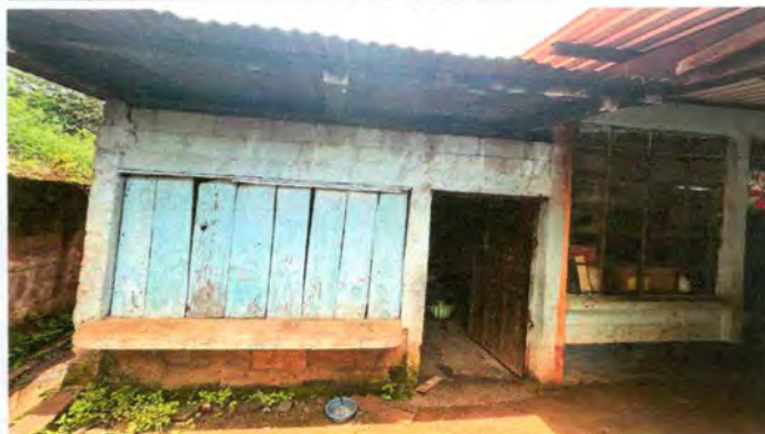
Foto 4: Nuestra cocina, se necesita remodelar por completo.
