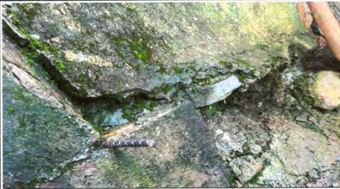
Foto 1: Muro de contención agrietado.
