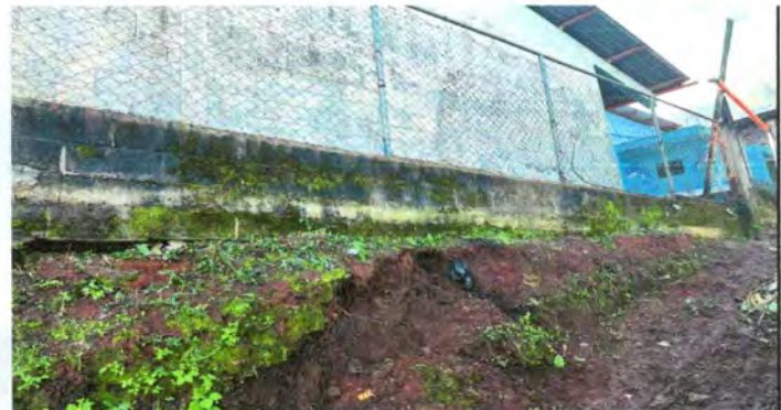
Foto 5: Se puede evidenciar el riesgo de derrumbe de este muro.
