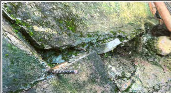
Foto 1: Muro de contención agrietado.
