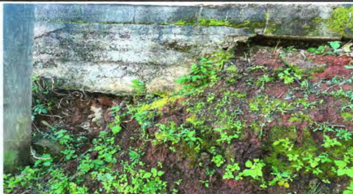
Foto 2: A causa de las fuertes lluvias los cimientos del muro están quedando al aire libre.
