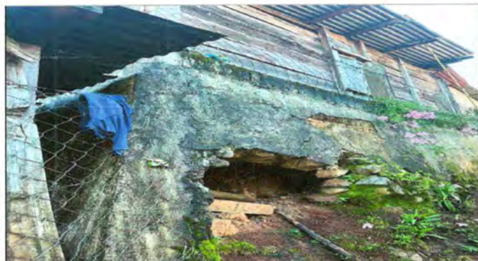
Foto 3: Está parte del muro es la más afectada.
