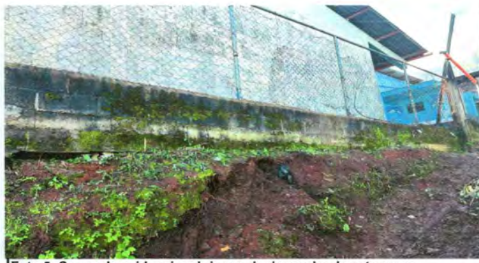
Foto 5: Se puede evidenciar el riesgo de derrumbe de este muro.
