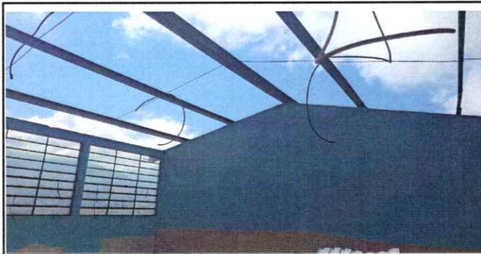
Foto 8: Aulas sin techo para cambio.
