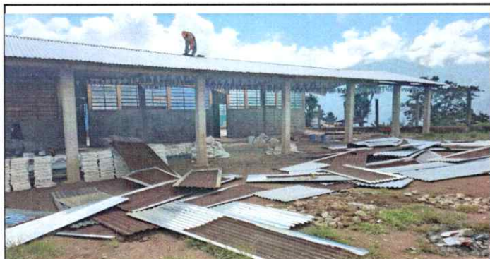
Foto 9: Laminas deterioradas para ser cambiadas
