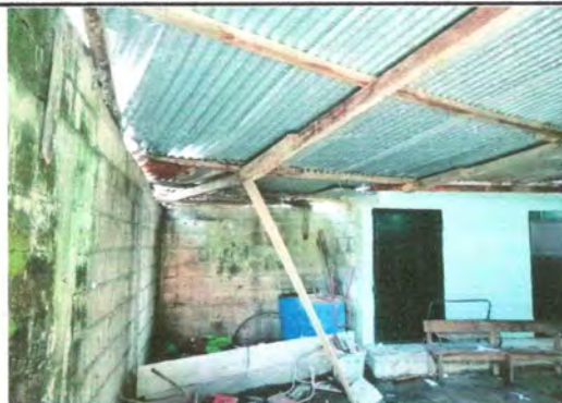
Foto 2: Techo peligroso para los estudiantes
