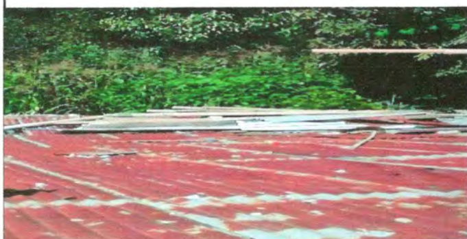
Foto 3: Techo en mal estado
