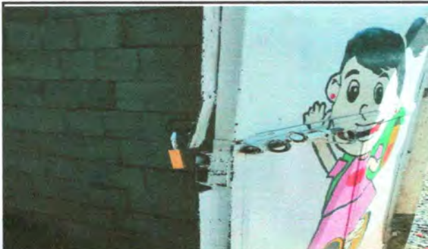
Foto 6: Portón en mal estado
