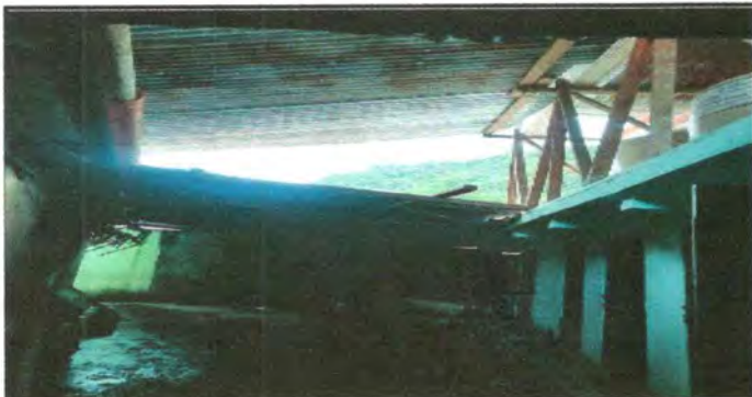
Foto 5: Techo en mal estado
