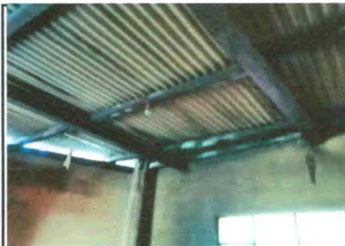
Foto 4: Lámina en mal estado
