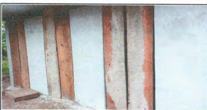
Foto 6: Baños sin puertas
