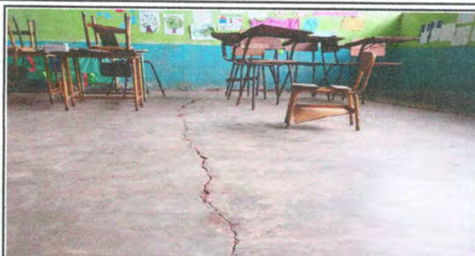
Foto 2: Piso deteriorado en salones
