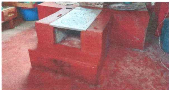
Foto 1: Estufa en malas condiciones
