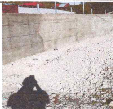
Foto 2: Muro perimetral en malas condiciones
