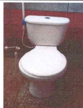
Foto 6: Inodoros en malas condiciones
