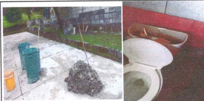
Foto 6: Inodoros en malas condiciones
