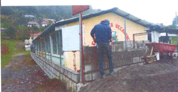
Foto 2: Muro perimetral en malas condiciones
