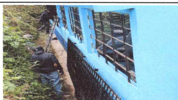
Foto 4: Sustrucción de balcones de metal en la parte posterior de las aulas.
